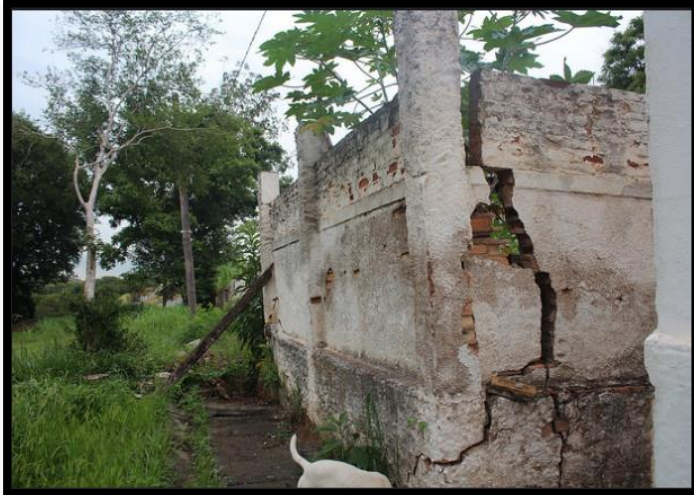
Rachaduras na construção
