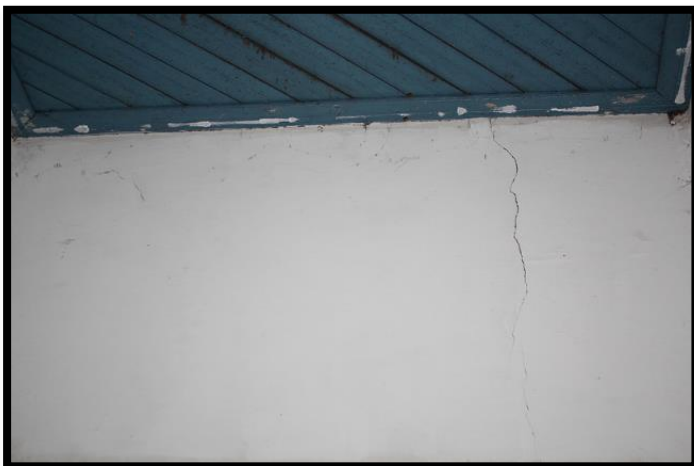
Rachaduras na construção
