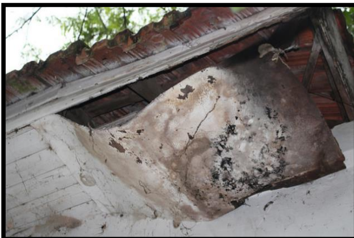
Falta de reparos no teto
