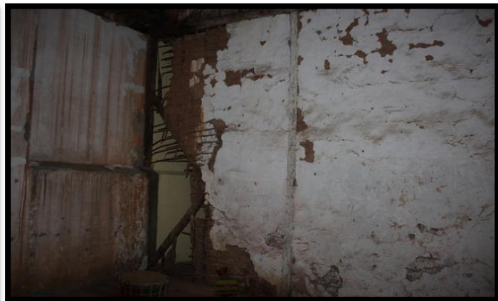
Rachadura na parede
