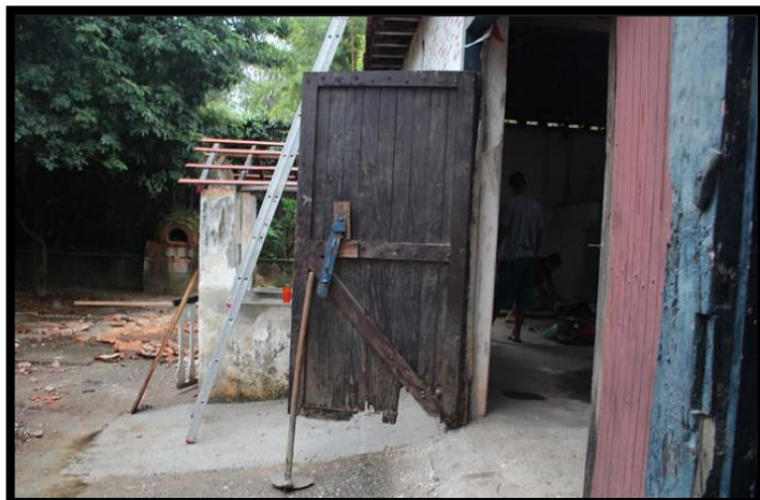
Danos na infraestrutura
