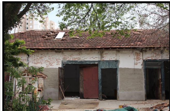
Falta de reparos
