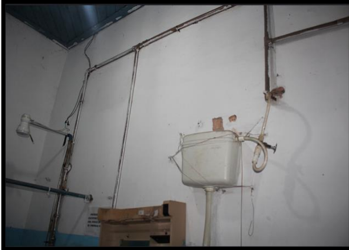
Falta de reparos no banheiro
